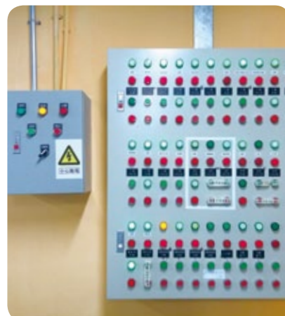
小區域照明控制系統
